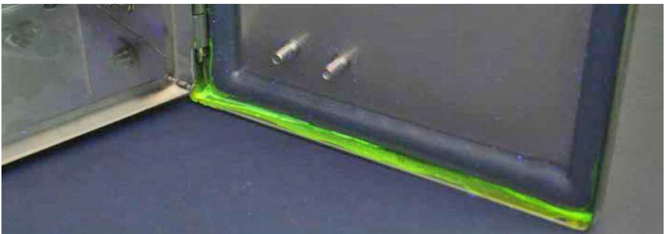
Figura 10 En un armario convencional, la limpieza no elimina toda la contaminación.
